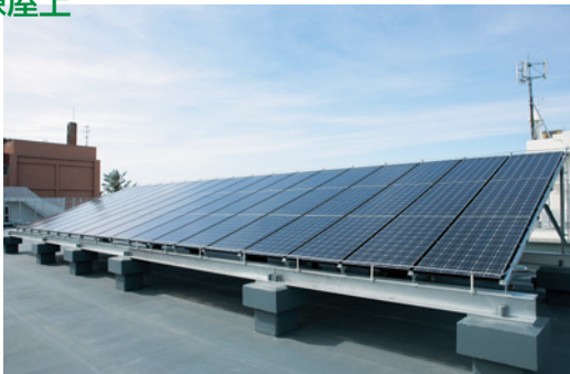
屋上の太陽光発電設備
